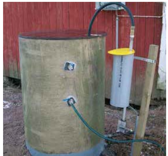
Kuva 32. Lirikaivoon asennettu automaattinen virtaamamittari ja datansiirtoyksikkö.
