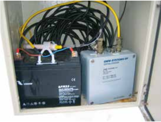
Kuva 16. Pohjaveden pinnan korkeuden automaattimittari ja datansiirtoyksikkö.
